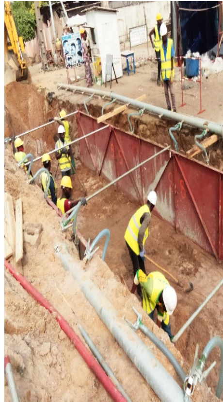
LIAISON CIM BENIN – CROIX ROUGE / CHAMBRE DE JONCTION : Construction de la chambre de jonction J7
