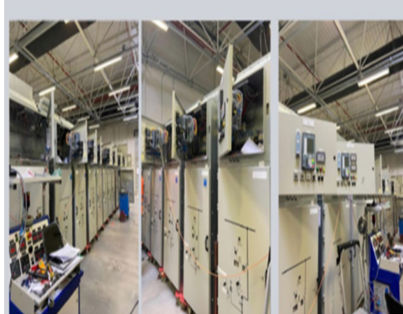
Inspection usine des cellules 15KV
