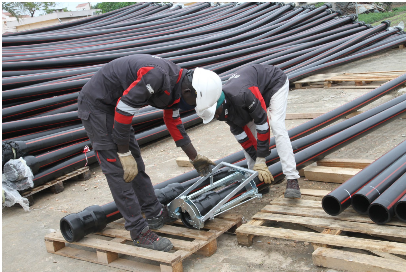
Image 2 : Préparation des tubes Polyéthylène Haute Densité (PEHD) sur la base chantier de EIFFAGE Energy System
