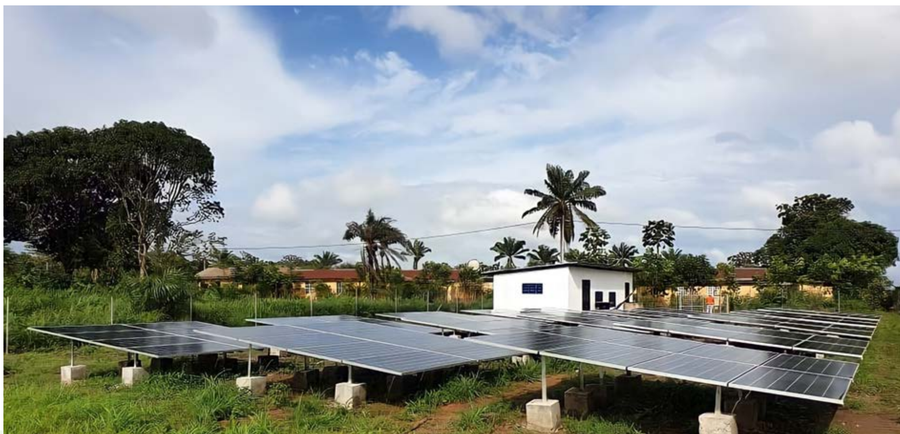
Mini-réseau du site de Hontonou- Commune de Aplahoué (Promoteur Energicity, projet Wéziza Bénin)
