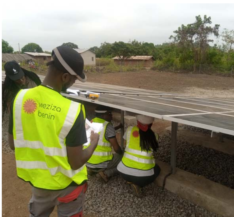
Inspection du mini-réseau de Takpatchiomé - Commune de Applahoué (Promoteur Energicity, projet Wéziza Bénin)
