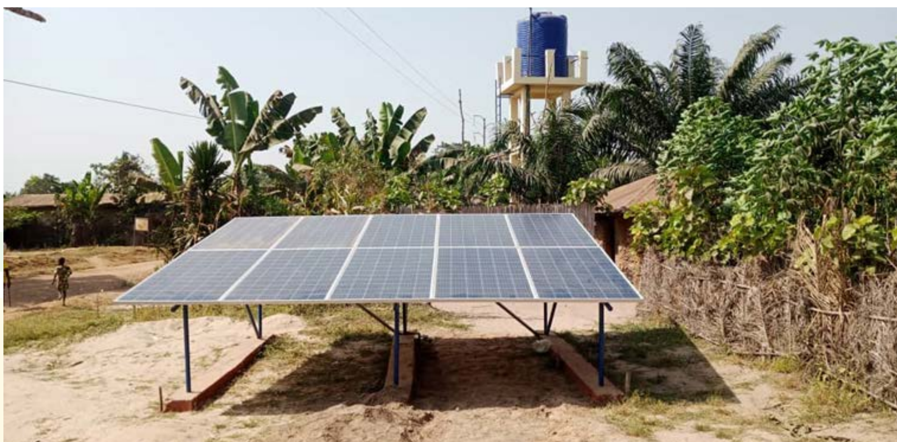
Générateur solaire pour le pompage au fil de l'eau de Zalimey - Commune de Zogbodomey (Promoteur ENERDAS)
