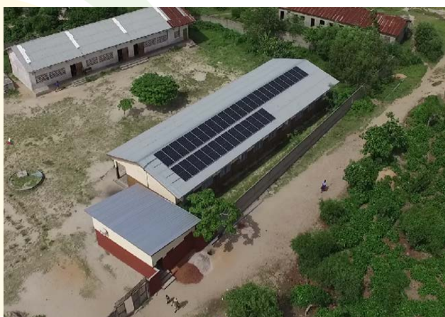
Café lumière de Djèkpé (mini-réseau) - Commune de So-Ava (Promoteur ESF-Électriciens Sans Frontières)
