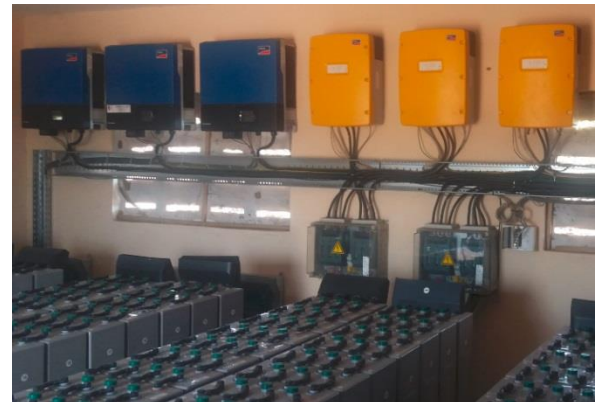
Figure 8: Parc de batteries et onduleurs du système 100% PV de Kabo (Bourgou)
